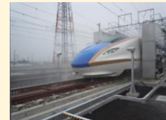
北陸新幹線白山基地 洗浄装置
